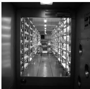
クリーンルーム内部
