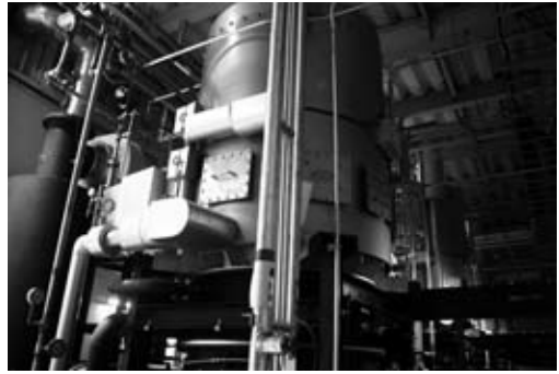
粟津工場のバイオマスボイラー
