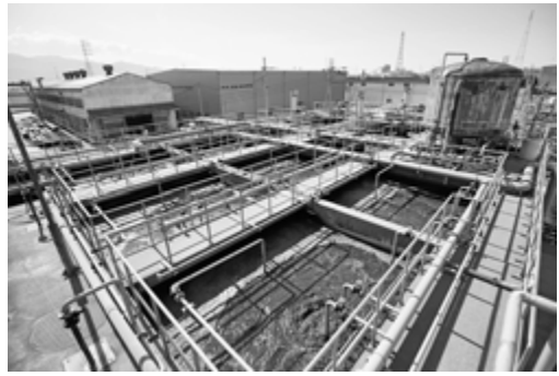
共同排水処理施設・インターワークス
