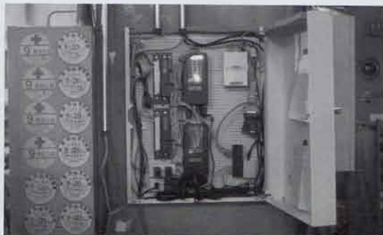
配電盤内の電流・電圧計測器。各設備の毎分の消費電力を計測しネットワークに送信している。
