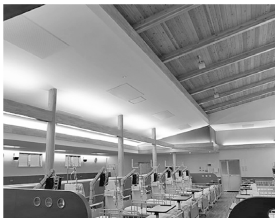
地中熱全館空調システムを導入した人工透析クリニック
